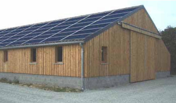
Image 1 : implantation de capteurs sur 100% de la couverture
