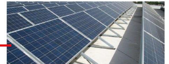
Panneaux solaires sur toiture
